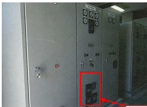
■ 高圧受変電設備
