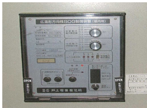
■SOG（継電器）制御装置（近景）
