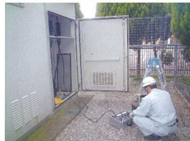
ケーブル絶縁診断
