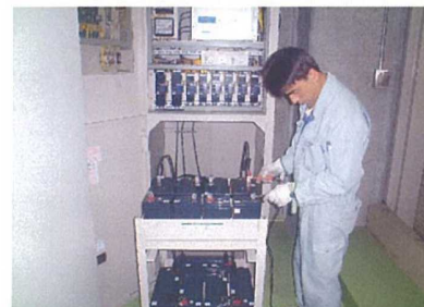
直流電源装置
