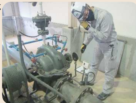
ポンプ聴音診断
