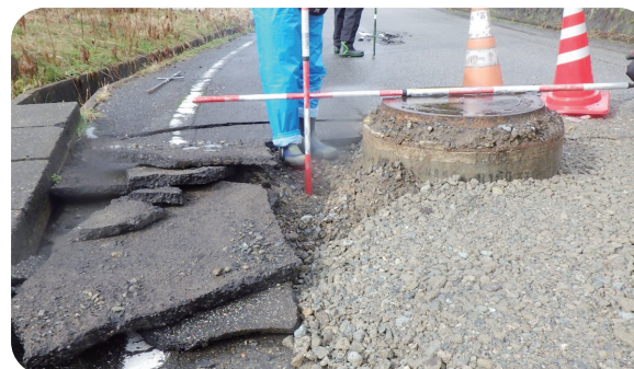
マンホールの隆起高測定
