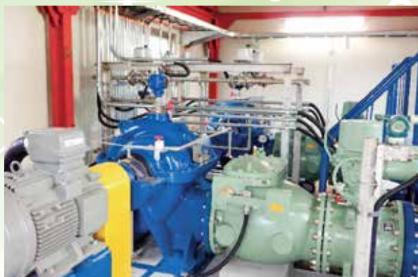
更新された揚水機 (彦根市三津屋土地改良区)
